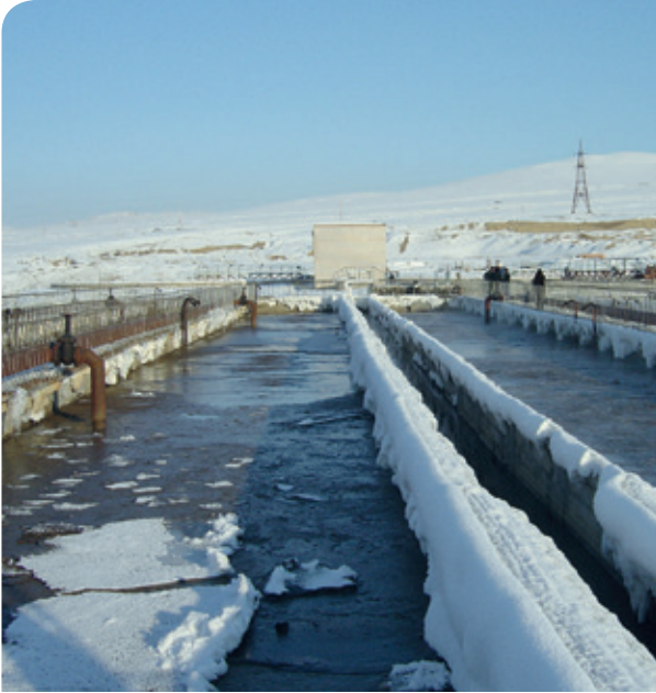
Veraltete Zentralkläranlage in Darkhan.
